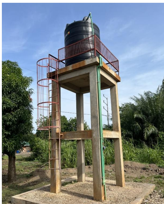
Photo 1 : Château d'eau a Tohou
